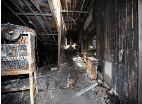
图5 坡道下方可燃物、墙面木质装修被烧毁（由东向西）
