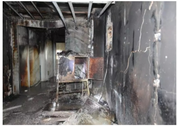
图6 配电箱底部可燃物被烧毁（由西向东）
