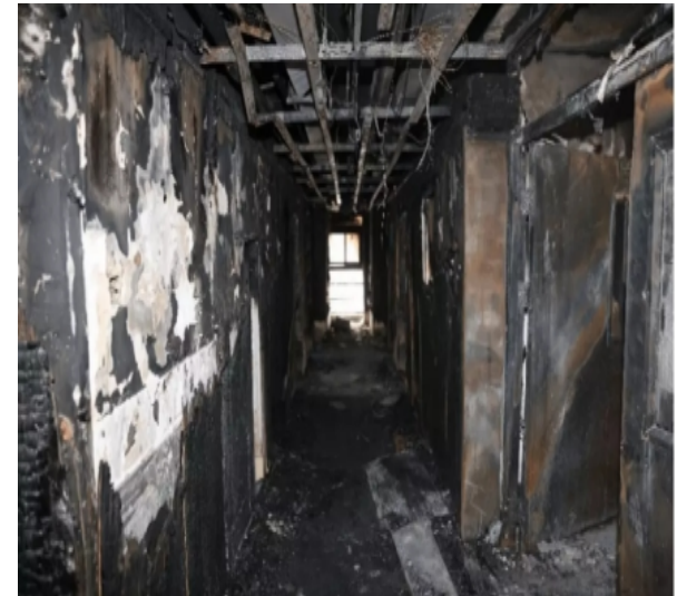
图8 南通道六层墙面过火情况（由东向西）
