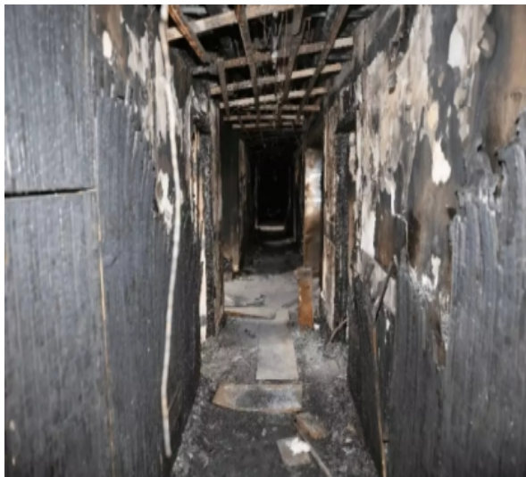
图7 北通道五层墙面过火情况（由东向西）
